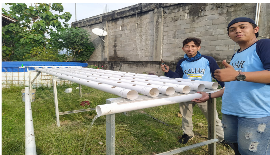
Gambar 3. Instalasi Hidroponik Sistem NFT Selesai
